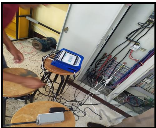
Figura 3. Verificación de la correcta conexión del analizador.
