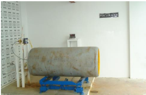
Figura 8. Dispositivo de inyección de cloro gas.
