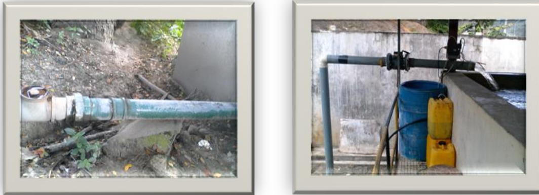
Figura 5. Líneas de conducción de agua cruda de río
