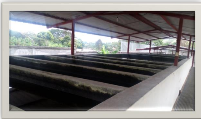
Figura 1. Piscinas de la planta de tratamiento de agua
