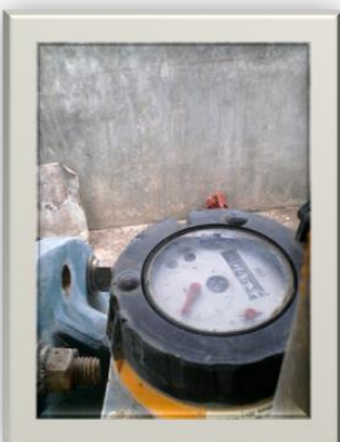
Figura 4. Medidor de agua
