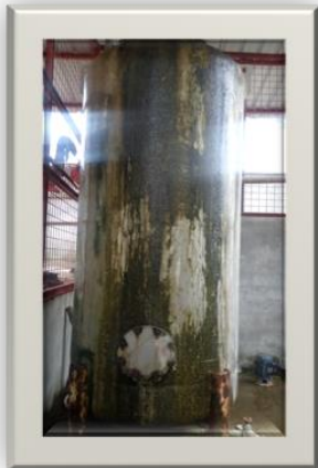
Figura 3. Filtro de arena
