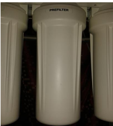
Figura 3. Filtro de carbón activado granular.
